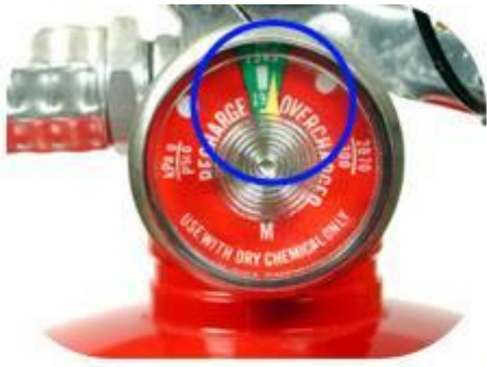
เครื่องดับเพลิง ใช้งานได้ปกติ (เข็มชี้ช่องเขียว)
